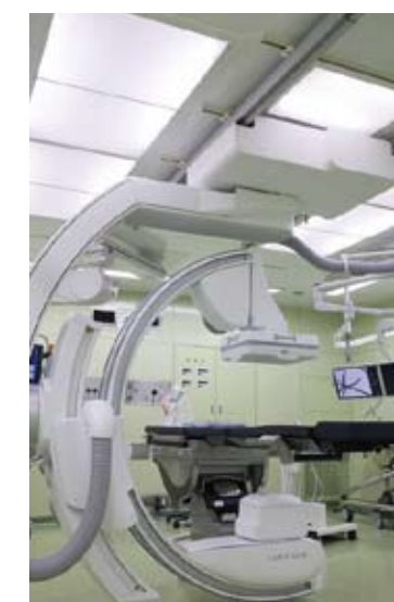
調光式LED照明内蔵型HEPAフィルタ※2ユニットを採用したハイブリッド手術室
