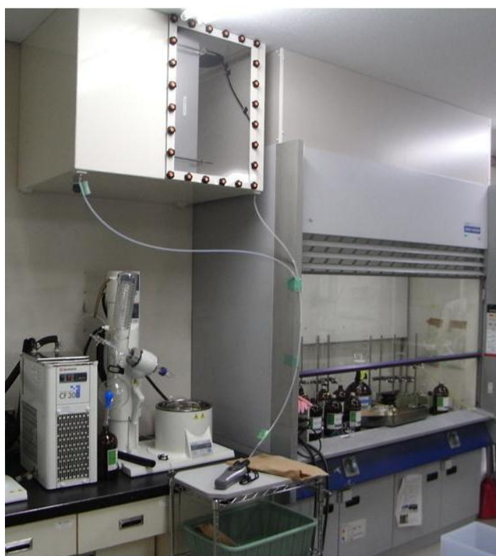
脱臭用フィルタを設置したドラフトチャンバー 設計・施工：株式会社イケヤ（奈良県香芝市，0745-79-2362）
