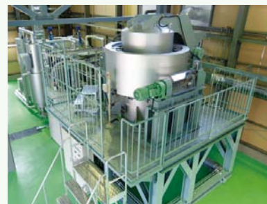
国内最大規模の超臨界CO 2 洗浄再生装置
