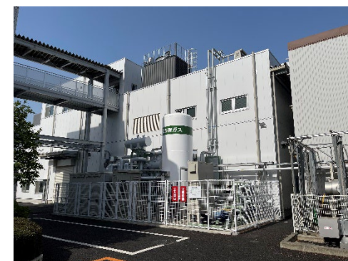
《増設した超臨界CO 2 プラント》
